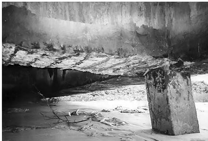
Hình 7. Sự ăn mòn cốt thép được xem là nguyên nhân chính dẫn đến hư hỏng của kết cấu BTCT trong môi trường biển.
